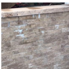
Dépôts minéraux sur une installation de murets.
